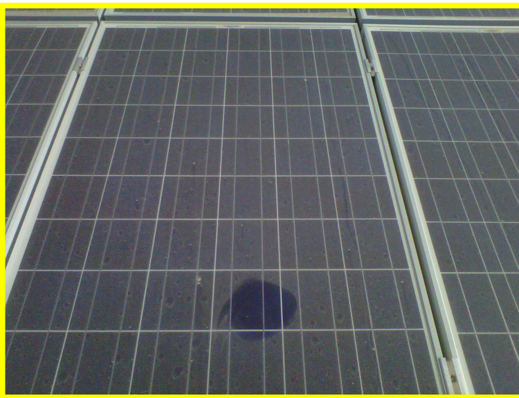
esempio di impianto su capannone con residui di polvere, smog e fumi aziendali
